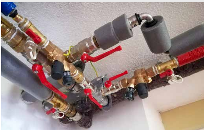
Vyregulovanie rozvodov TV v BD
